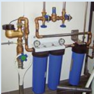
Ganzhausfilter mit Vorfilter und Kalkbehandlung
